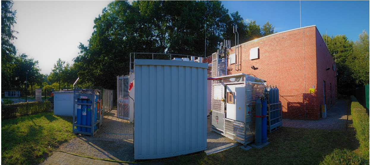
Außenansicht der Power-to-Gas-Anlage am Standort des Feldtests in Ibbenbüren. Rechts im Bild die ORBIT-Biomethanisierungsanlage, die aus dem Elektrolyseur vor Ort grünen Wasserstoff mit \text{CO}_2 aus der Bioethanolerzeugung in erneuerbares Methan wandelt und in das Gasnetz einspeist. Foto: OTH Regensburg/Martin Thema
